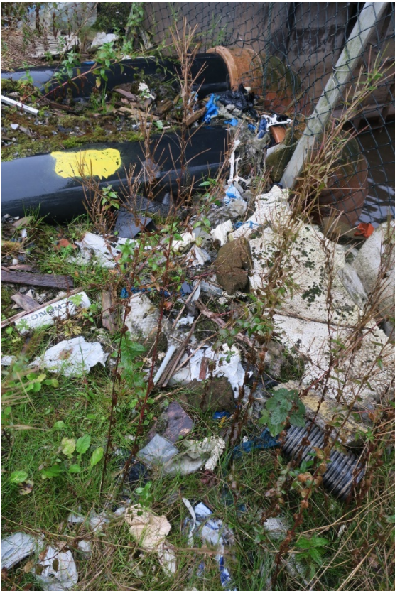
Avfall, bl.a. begrodd EPS, ved innløpet til bassenget for sigevann.
