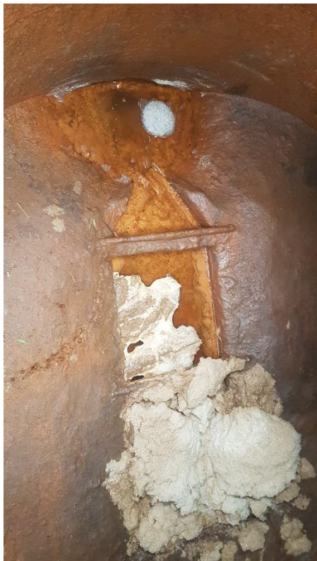
Figur 14 Utfelling i sigevannsystemet reduserer kapasiteten. Foto: O. Soldal 04.05.2021
