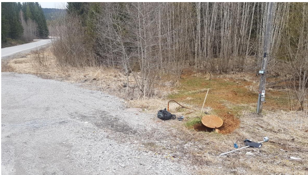
Figur 15 Lekkasje av sigevann fra en kum. Rødfarge viser hvor sigevannet har rent (COWI, 2021). Foto: O. Soldal 04.05.2021.
