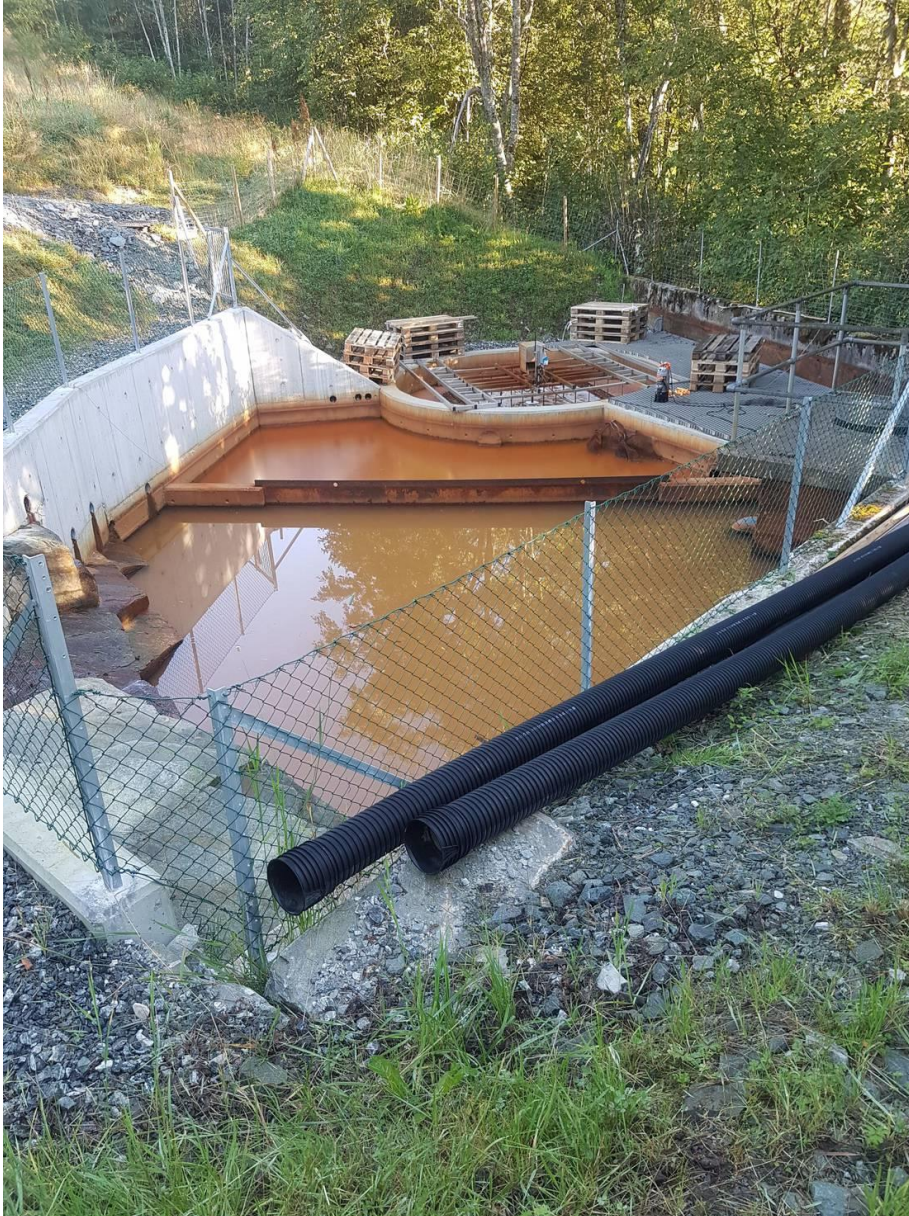
Figur 19. Bildet viser et rundt luftebasseng i bakgrunnen og et sedimenteringskammer under gitter samt i midten av bildet. Vannet i forgrunnen er renset for mer enn 80 % av jernet.
