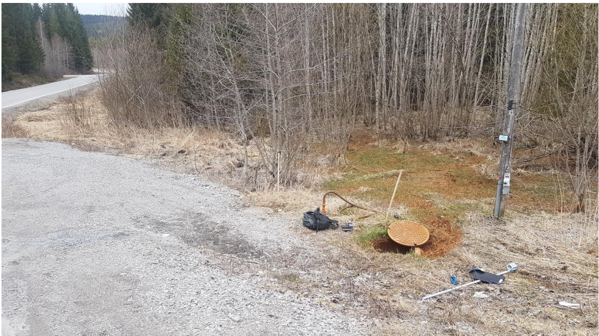
Figur 13. Kum 45932 før overføring til kommunalt renseanlegg. Brunfarge i terrenget viser at det har vært overløp av sigevann ut av kummen.
