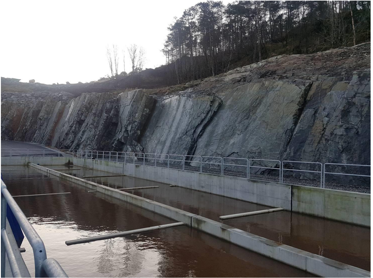
Figur 18. Eksempel på store støpte sedimenteringsbasseng.
