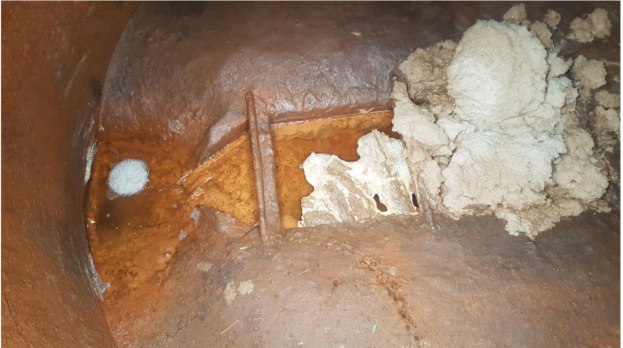
Figur 14. Kum 45932. Samlerør ut fra deponiområdet i retning kommunalt renseanlegg. Diameter på rør er 110 mm (Steinkjer kommune pers medd.). Det sees mye rustbrun jernutfelling.
