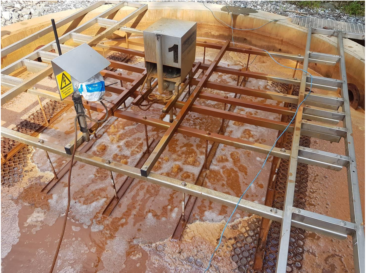
Figur 20. Luftebasseng med biofilter (svarte ringer) for å øke jernutfellingen.
