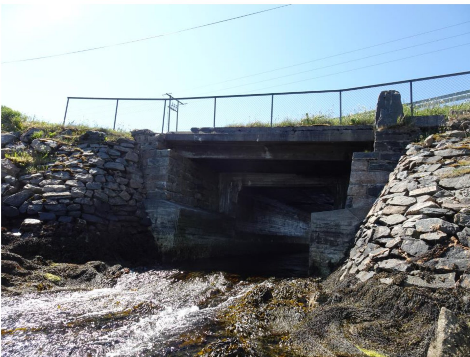
Figur 1-3. Utløp til bru, øst for veien. Ytterst ligger den eldste delen i mur og lenger inn den nyere delen i betong. Bilde: Trøndelag Fylkeskommune.
