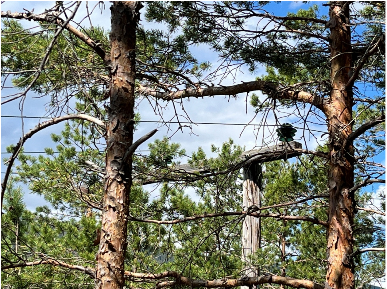
Figur 5 Den gamle 22 kV-linja har ikkje vore i bruk og er i dag attvokst med skog. Den bør fjernast før den fell ned, for å unngå å bli ein fare for folk og dyr. Foto: Statsforvaltaren i Vestland/ Maria Knagenhjelm.
