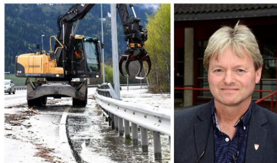
FLOM: En gravemaskin ble satt inn for å hindre at elveløpet tettet seg der Tromsø renner under E6 ved Fåvang. Natt til lørdag ble E6 liktallstranen T11 hevet. Ordfører Arne Fossmo, Ringebu. Fotomontasje: Kari Utgaard
