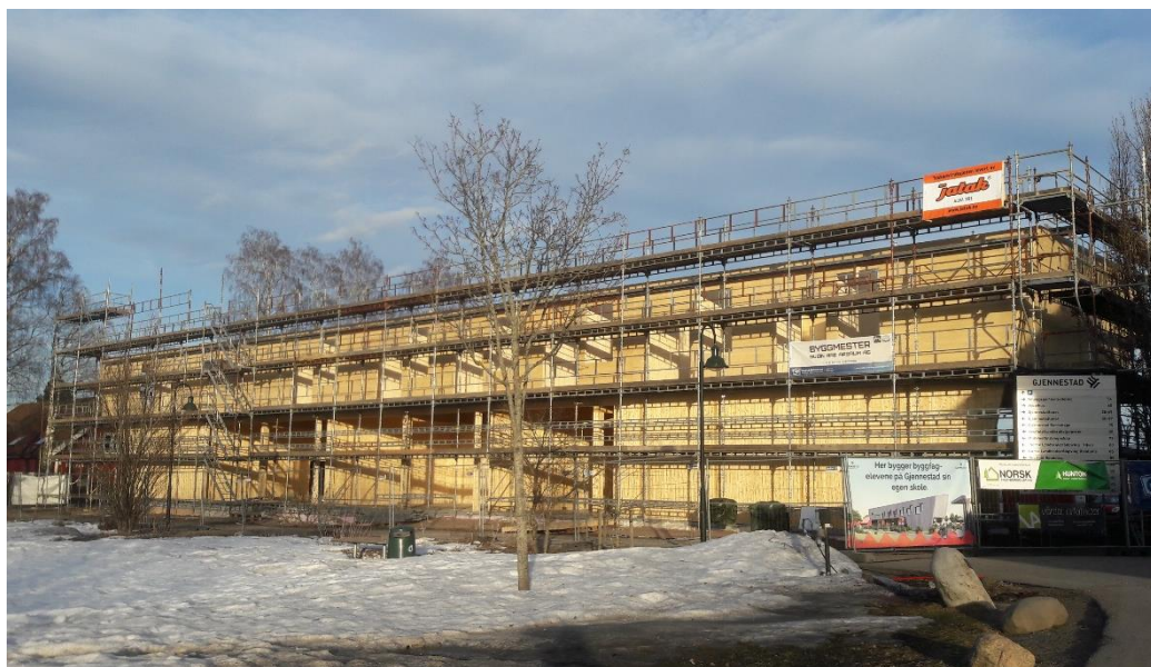
Karbonlagring i trebygg. Splitkons første leveranse av KLT-moduler fra den nye fabrikk var nytt undervisningsbygg til Gjennestad videregående skole i Stokke. Bygget ble satt opp av skolens egne byggfagelever. Foto: Ingrid Knotten Haugberg, FMVT.
