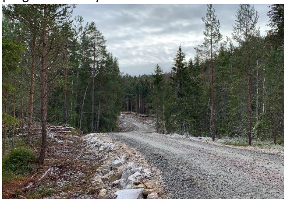
Nybygd skogsbilvei Trytetjønnvegen i Flåbygd i Nome kommune. Veien er bygd opp av sprengt og knust fjell. Foto: Per Kristoffersen, FMVT.
