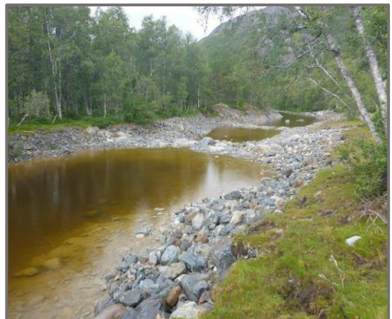
Figur 33: Storåna ved Mostølen. Tersklar og erosjonssikring etablert ved tiltak i vassdraget i 2019. Bilde: Statkraft
