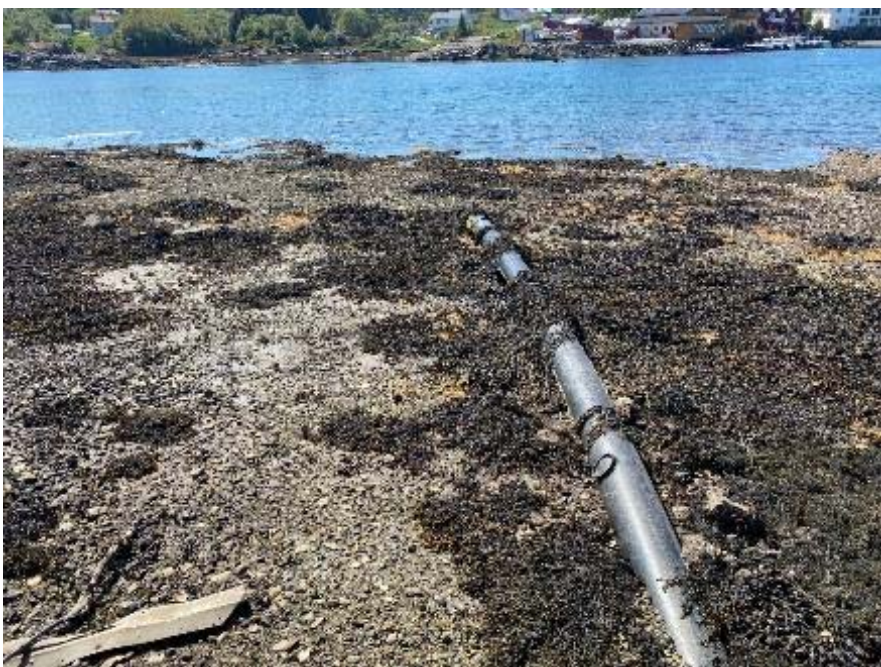
> Foto 7: Rørledning som ligger nordvest for område 1. Denne ligger utenfor område for planlagt fylling
