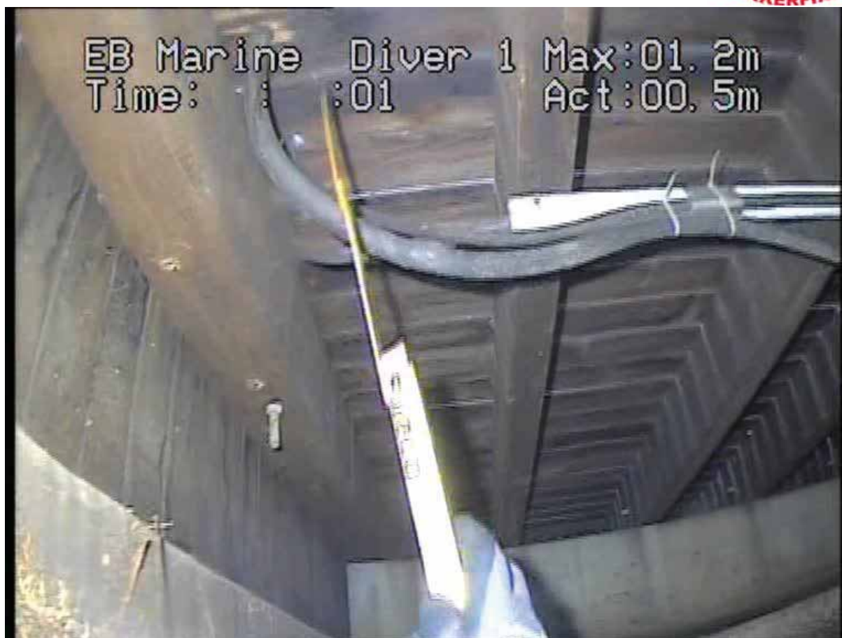
Strømledninger som går opp i kaidekk ved UT2.
