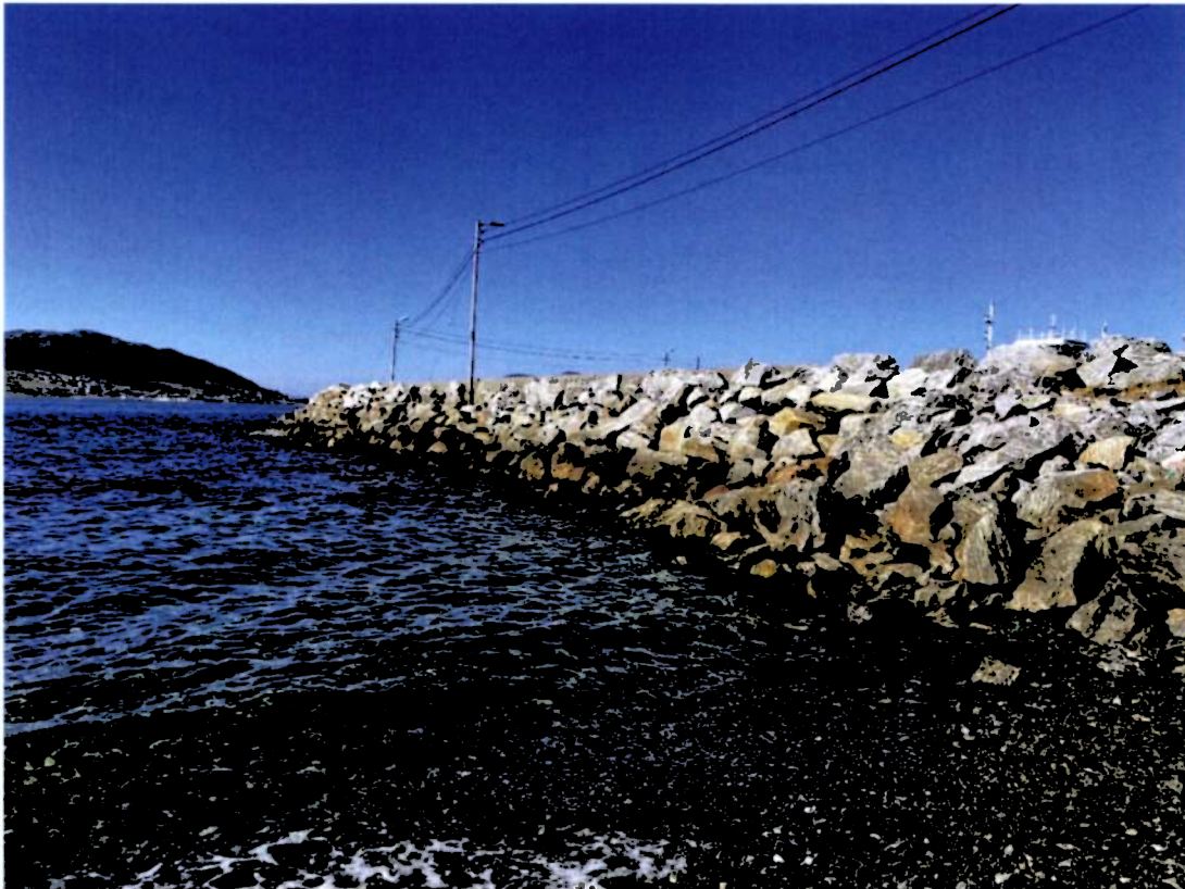
Figur 10 Foto 1 av moloens kortsider ut fra land mot sjøen. Blokkene er lagt ut som en ordnet raus med et stort spekter av blokkstørrelser. Dekklaget later til å være intakt uten store skader.
