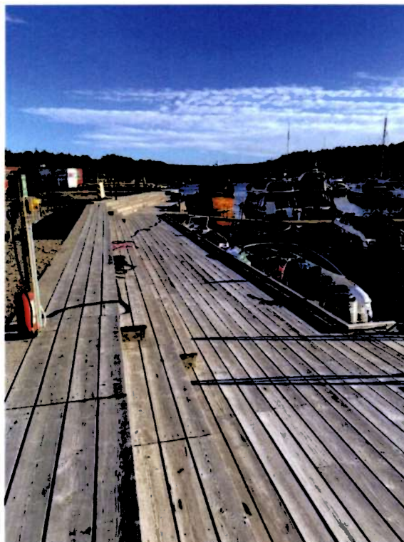
Figur 16 Eksempel på nedsenket brygge ved Edholmen. Fyllingen til venstre i bildet ligger på flomsikkert nivå. Foto: Norconsult.
