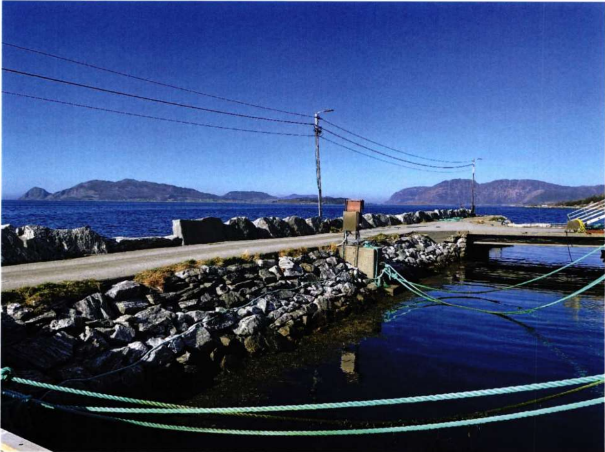
Figur 14 Foto 5 av moloens innside tatt fra den innerste trekaia. Baksiden er bygget opp som en plastring og later til å være i god stand. Man ser også at brystvernet mot sjøen hever seg ca. 1 m over molodekket.
