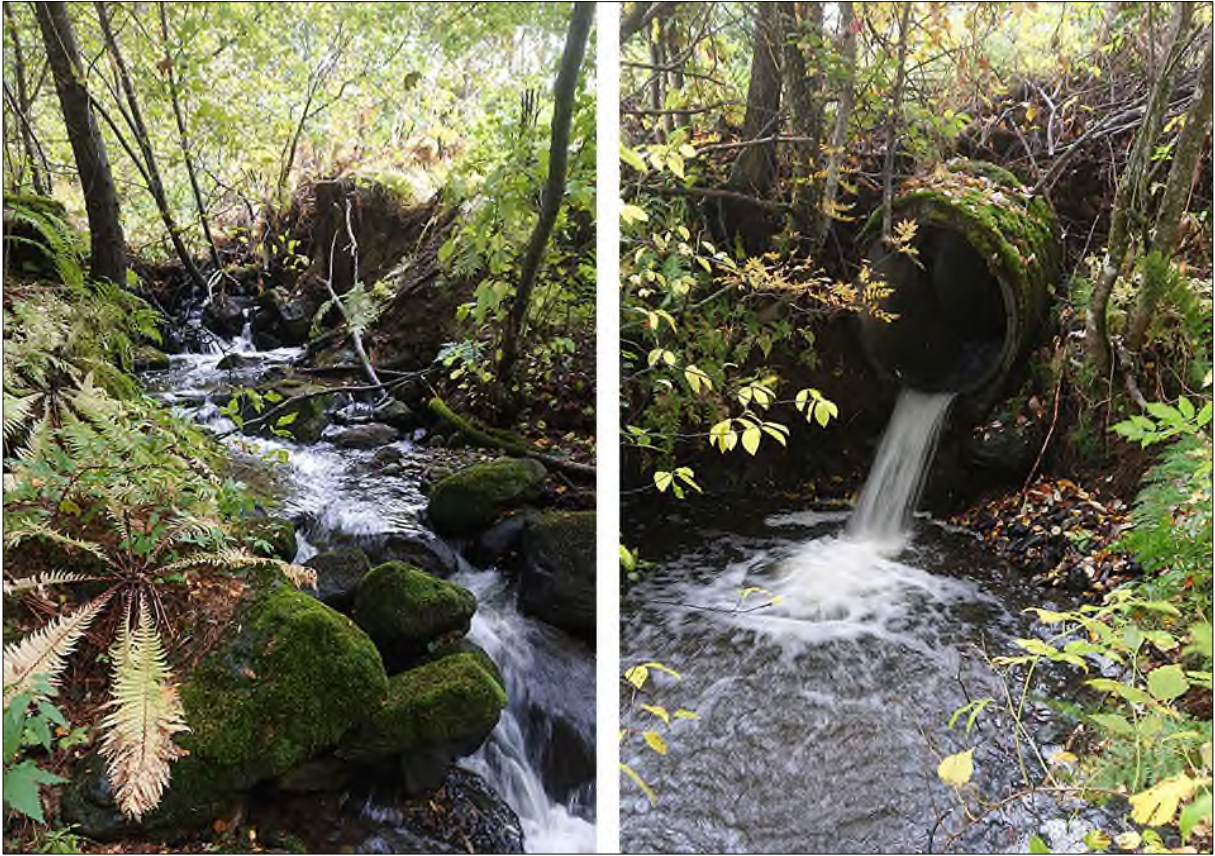
Figur 21. Vandringshinder i Myrbakkbekken.
