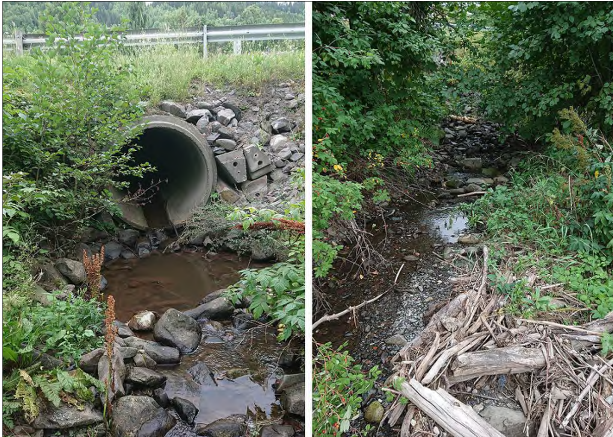
Figur 35. Bulungsbekken går i stikkrenne under dagens E6.
