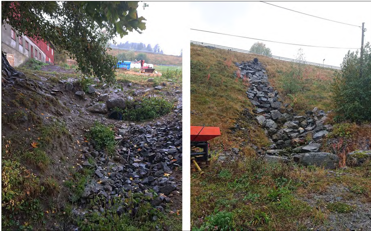
Figur 6. Roterudbekken passerer Roterud gård og ligger i en hengende rørkulvert under dagens E6.
