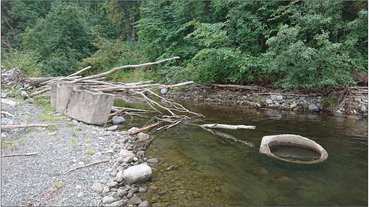
Figur 19. Kalverudelva er forsløplet med gamle betongelemerter i utløpet.
