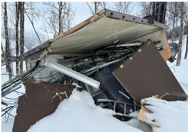
Figur 2: Mobilstasjon ødelagt av snøskred 31. mars 2023. Stasjonen og masten skal re-etableres på et sikrere område. (kilde: Telenor)
