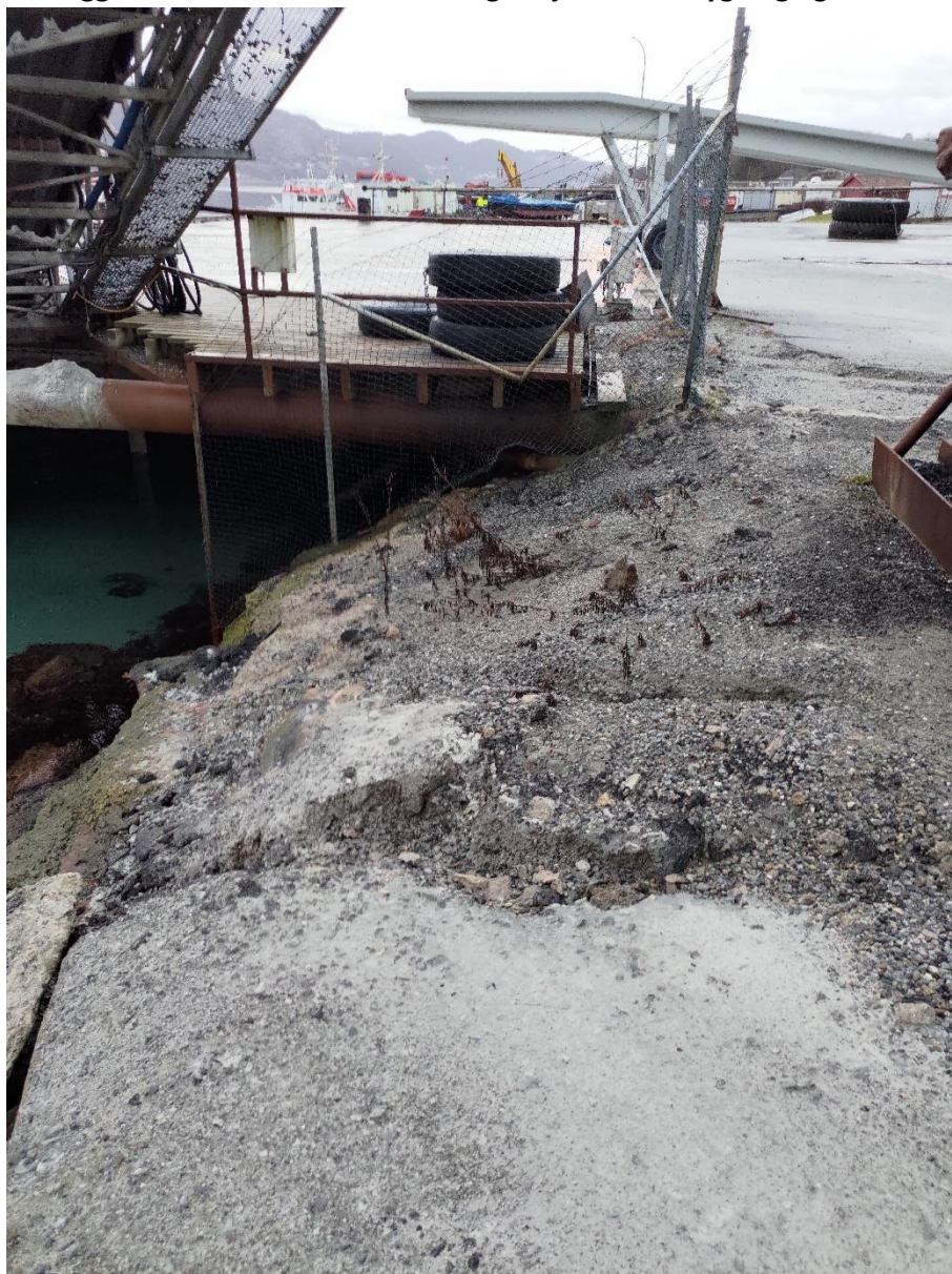
Vedlegg 4: Bilde av overflateavrenning til sjø mellom bygning og kai
