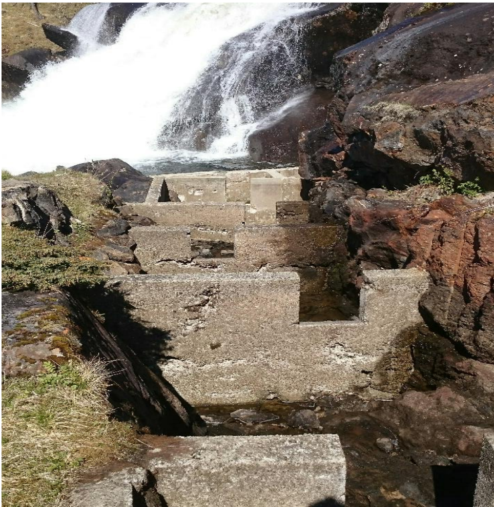
Bilde 2: Viser nedre parti av Forsåfossen fisketrapp. Tilstand før åpning mai 2016. Trappa bærer preg av omfattende skader på mur. Foto: Robin Sommerset 2016.
