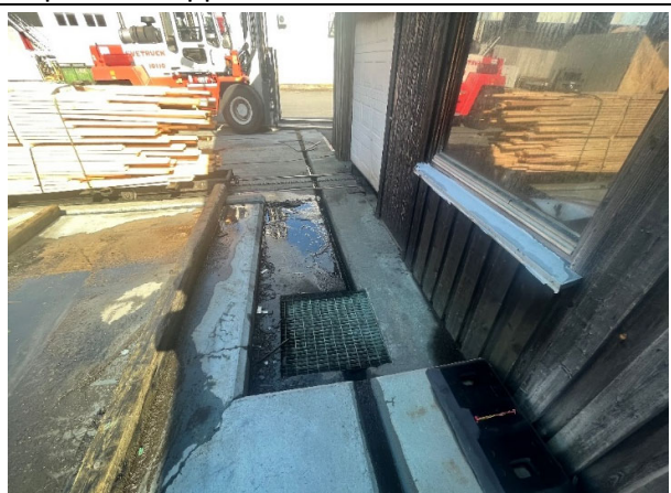
Imp. væske som renner av trelastpakkene, samles opp i kum og gjenbrukes.
