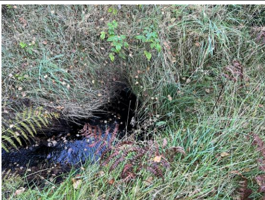
Bilde 10. Bekk forsvinner i steinlagt kanal.
