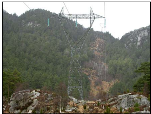
Kraftledninger kan være en fare for viltet, særlig større fugler som hønsefugler og rovfugler er utsatte. Foto: Magnus Johan Steinsvåg.
