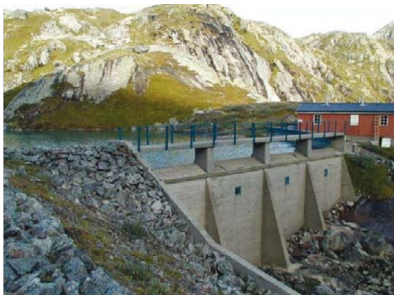
Vernereglane for nasjonalparken er ikkje til hinder for drift og vedlikehald av energi og kraftanlegg. Demning i Blåvatnet, Odda. Foto: Anniken Friis
