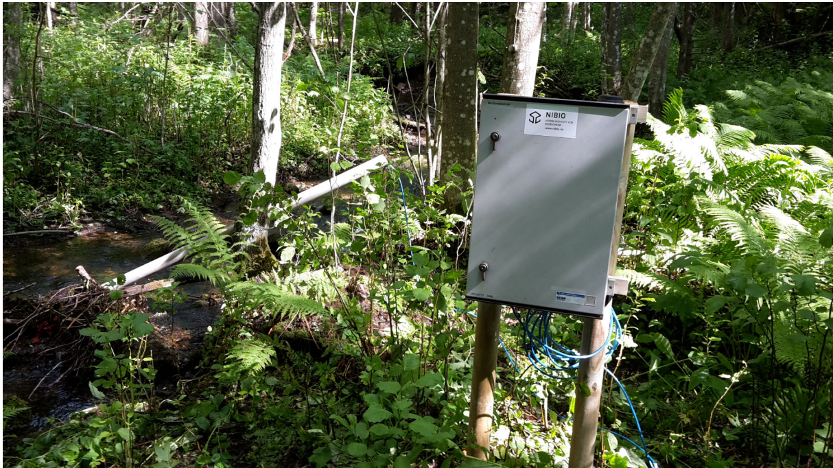
Figur 9. Stasjonen NOR i Nordlandsbekken. Viser utstyr for automatisk overvåking etablert for Ringeriksbanen i 2017 (Foto: Roger Roseth, NIBIO).
