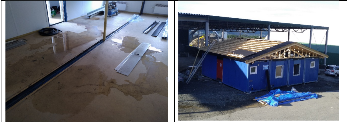
Figur 2: Brakker kjøpt inn pga. Korona epidemien. Pga. lekkasjer i taket i skjøtene mellom brakkene, så ble det bygget et tak sommeren 2020.
