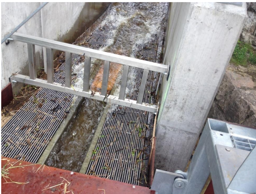
Figur 12. Finnist i fiskeavlederen ved Herting kraftverk i Ätran. Formålet med rista er å skille ut nedvandrende fisk fra vannet, ved at fisken sklir oppå rista ned i en oppsamlingsrenne som føres til et oppsamlingsbasseng. Foto: Norconsult Sverige.
