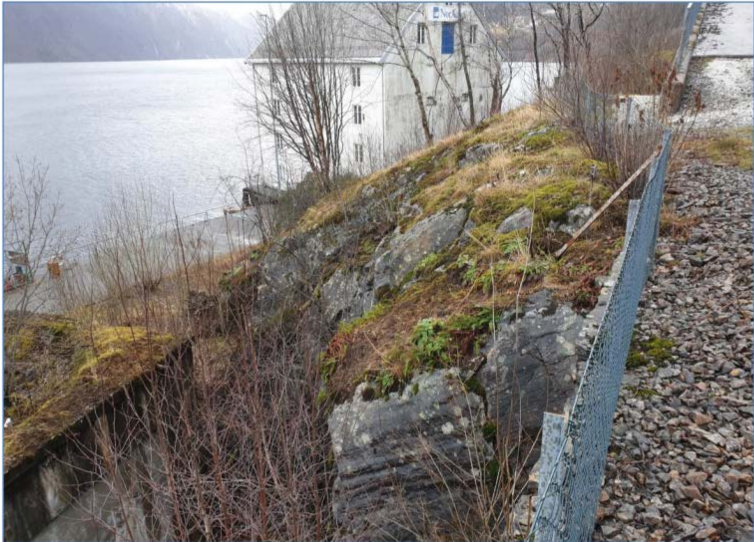
Figur 34. Bilde av området for påhugget ved Bogo kai. Utrangert silobygg ses i venstre bildekant. Gjerdet står på en mur.
