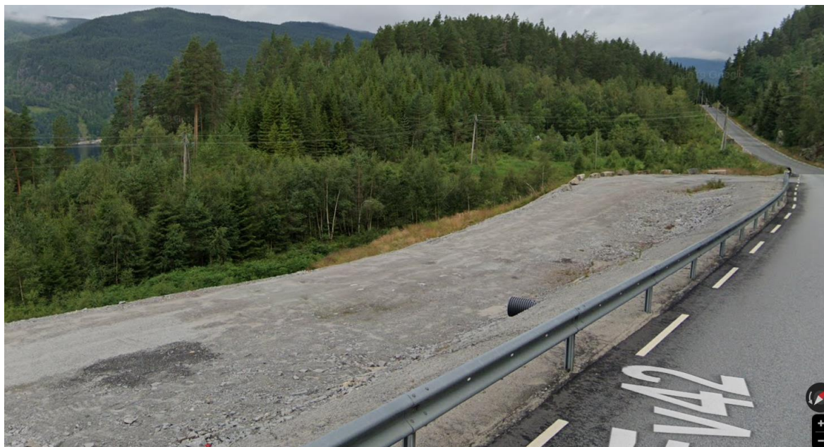
Figur 6 Høyspentlinje 22kV nedenfor dagens steinfylling i Haughombakkene. Sett fra sør. Google streetview.
