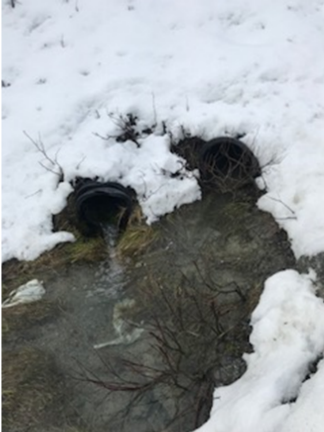
Figur 5: P3 a) (rør til høyre i bildet) og P3 b) (rør til venstre i bildet)
