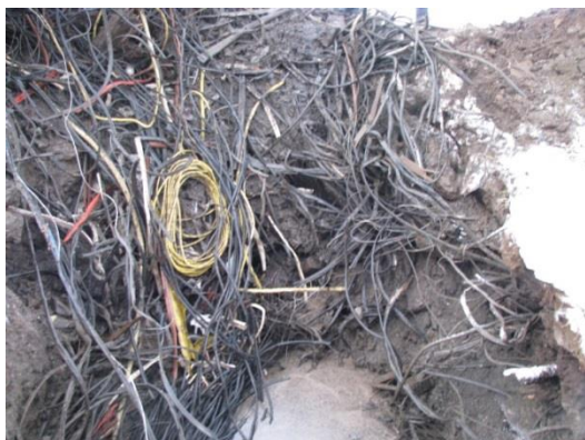
Figur 7: Sjøppel i sjakt 1 fra grunnundersøkelsen utført av Asplan Viak vinteren 2012/2013.
