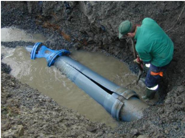
Figur 1 Eksempel på sprukket vannledning i PVC (foto fra Norsk Vann rapport 196/2013)
