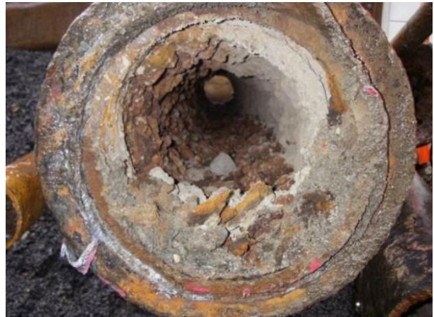
Figur 2 Eksempel på vannledning i grått støpejern (foto fra Norsk Vann rapport 196/2013)
