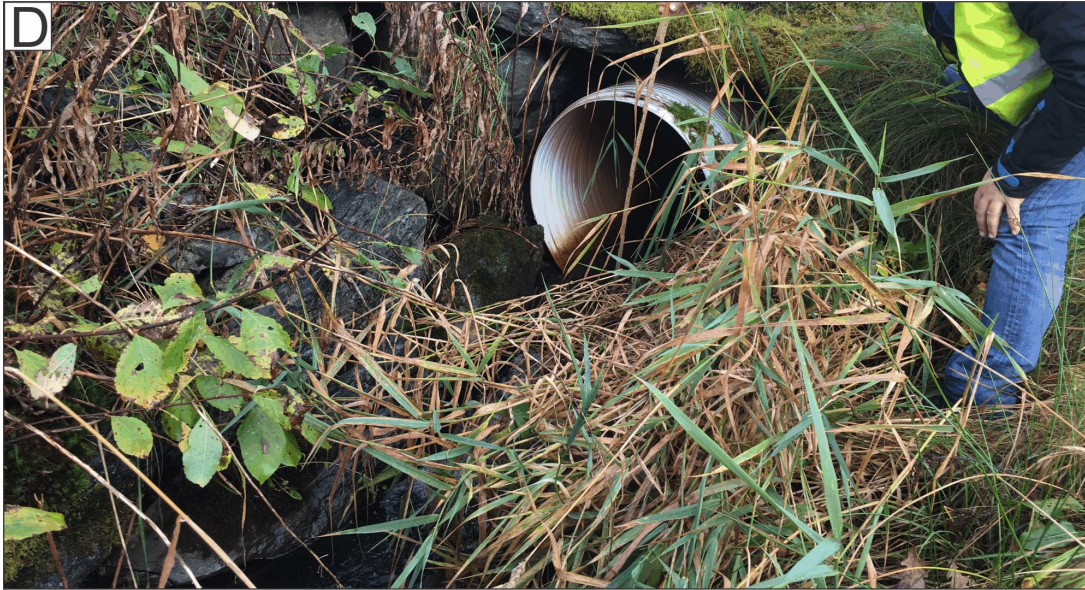
Figur 16: Ei vassgjennomføring ca. 100 m nordvest for Kleivaelva. Bekken renner på vegfylling av skotstein.
