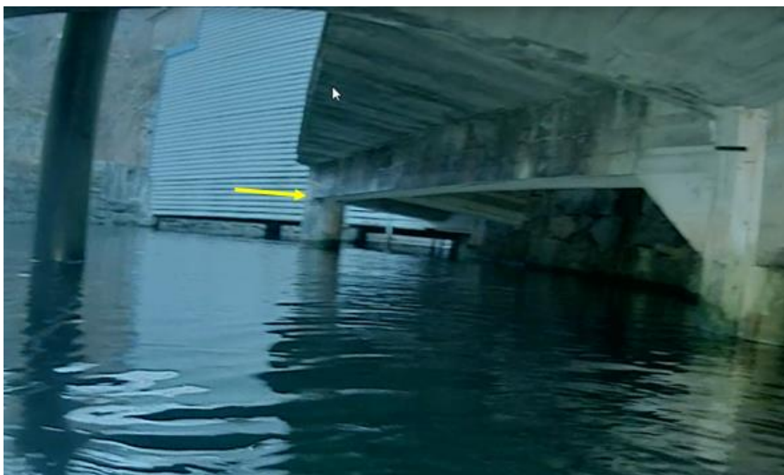
Figur 3-3: Bilde er tatt fra under eksisterende bru og nordøst mot det eksisterende bygget i elven. På bildet sees eksisterende natursteinmur og kaidekke. Gul pil markerer eksisterende betongsøyle som støtter denne delen av kaidekket. I bakgrunnen sees eksisterende bygg med betongstøtter ute i elven. Foto: IMC Diving.
