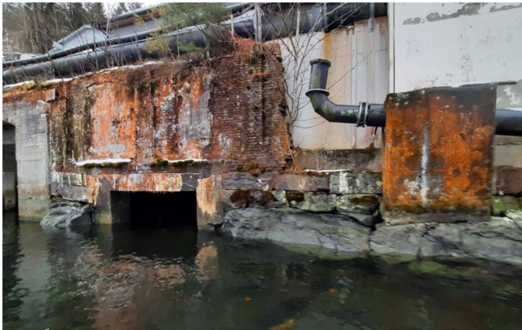
Figur 3-4: Tiltaksområdet i elv avgrenses i nordøst av betongkulvert til venstre i bildet (rustet konstruksjon og teglstein). Denne skal fjernes. Til høyre sees ett av åtte betongstøtter for det gamle avløpsledningen. I bildet står betongstøtten på berg, mens de resterende syv støttene ser ut til delvis å henge utenpå natursteinsmuren og delvis stå på elvebunnen. Foto: Multiconsult.
