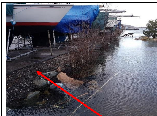
Prøvetatte grusmasser (AG-1) mellom asfalt og sjøen ved Auglandsbukta småbåthavn (foto: COWI).
