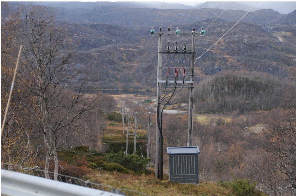
Mast nr. 14: Fareklasse A. Beliggenhet A. Trafo på bakken. Komplisert mast. Foto: Jan E. Gunnersen.
