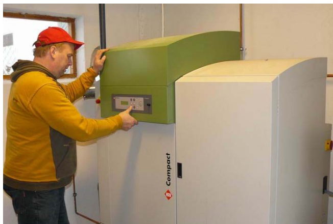
Nytt gardsvarmeanlegg for bioenergi i Ringsaker høsten 2008. Foto: Eiliv Sandberg
