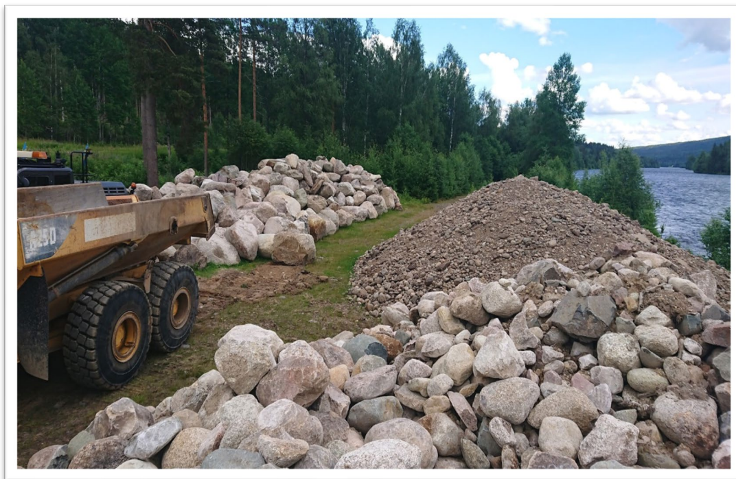
Figur 27 En av avläggsplatserna med till vänster block (+750 mm), i framkant syns sten (+300mm) och bakom lekgrus.
