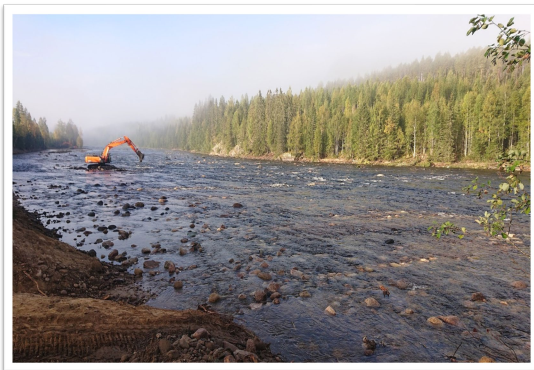
Figur 30 Maskiner i arbete med att lägga ut sten från schaktvallarna längs älvens stränder. Sträckan uppströms grävmaskinen är återställd.
