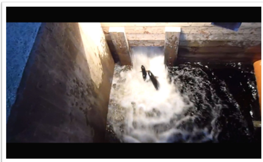
Figur 19 Fiskvägens översta del har ett "false weir" ("vattenfall"), som lockar fisken att hoppa upp mot vattenströmmen varefter den, via röret som skymtar till höger i bild, leds vidare till uppsamlingsbassängen. Foto: Länsstyrelsen Värmland.
