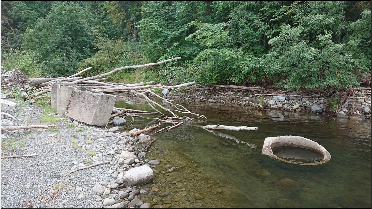
Figur 19. Kalverudelva er forsløplet med gamle betongelementer i utløpet.
