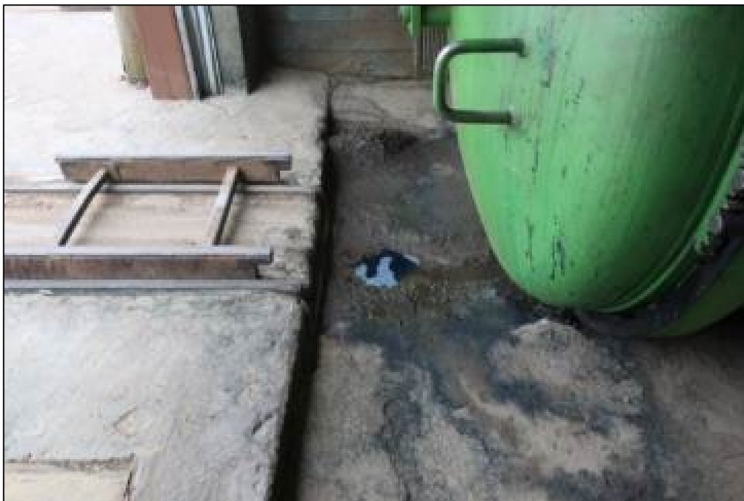
Figur 3-1 Oppsamling med sluk til tank. Det er generelt fare for lekkasje gjennom svakheter i asfalt og betongdekke. Grønn beholder er impregneringskammeret.
