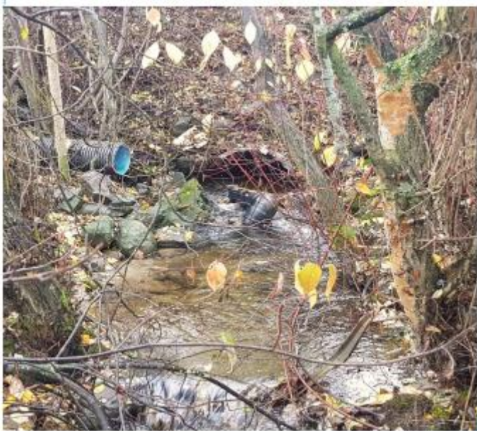
Figur 6: Fra kartlegging av førtilstand utført av Sweco i 2018, utløp under fv. 213 og ut i Mjøsa (Sweco, 2018).
