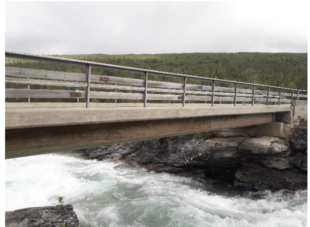
Bru med stålbjelker som begynner å ruste. Foto: Carl Olav Holen
