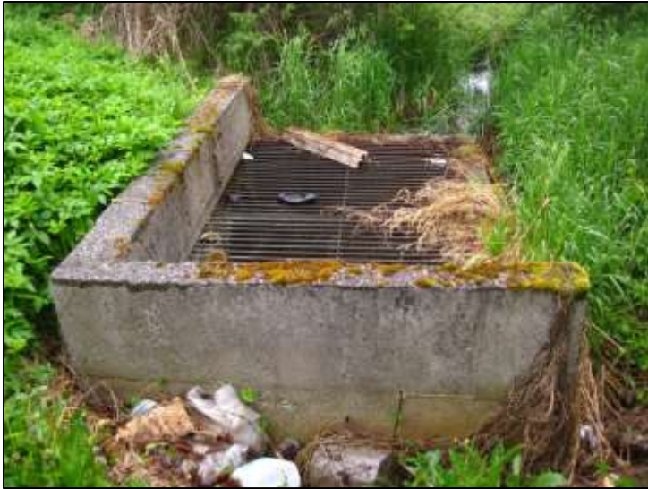
Figur 9 Det er store lekkasjar rundt overløpskummen, og nedre del av vatnet er seinka minst 50 cm pga. dette.
