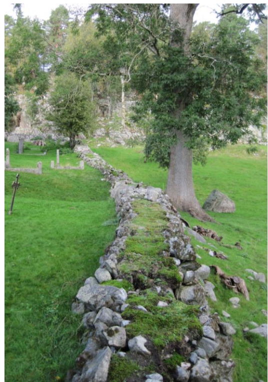
Figur 8: Stein rasar ut frå muren. Foto: Fylkesmannen
