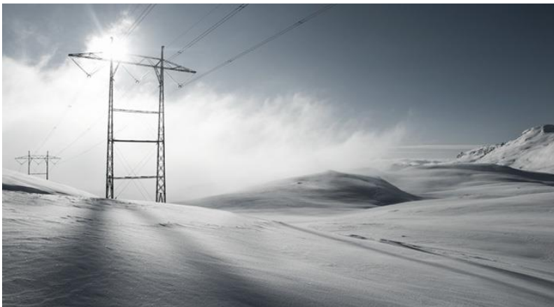
Figur 3.9. Utbygging og vedlikehald av overføringsliner er viktig for ei robust strømforsyning. (Foto: Statnett)
