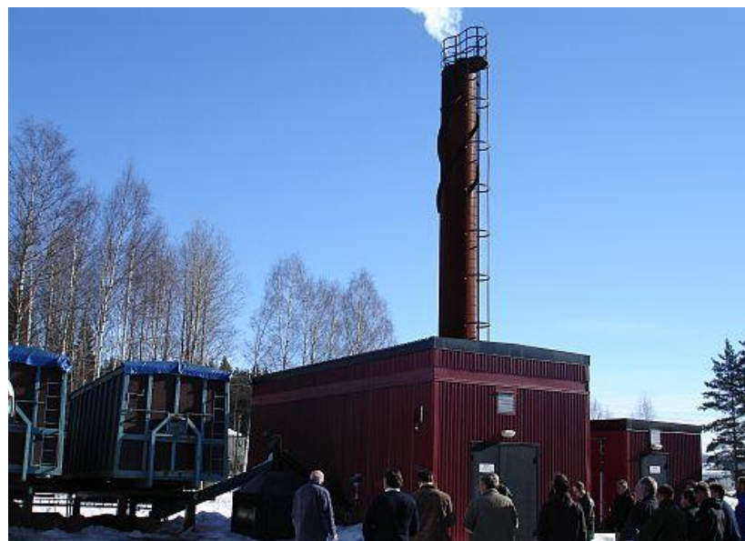
Flisfyringsanlegg i containerløsning, Foto: Fylkesmannen i Nordland
