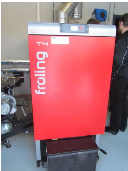
Gårdsvarmeanlegg (75 kW), Foto: Fylkesmannen i Nordland
