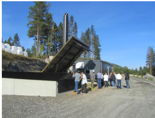
Flisfyringsanlegg i Tingvoll, Foto: Fylkesmannen i Nordland
