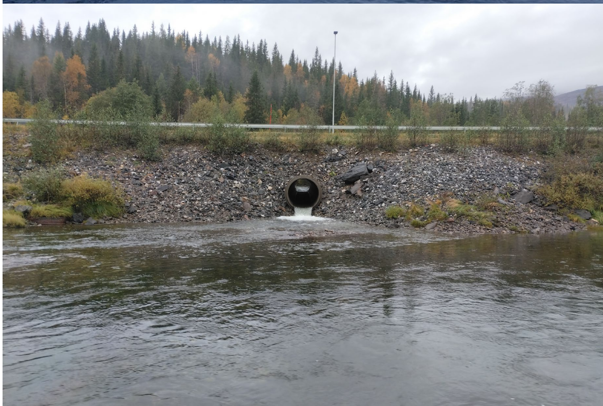
Bildeserie 9. I forbindelse med bygging av ny E6-trasé nord for Mo i Rana, har Neveråga blitt gjort utilgjengelig for oppvandrende fisk. Den feilkonstruerte veikulverten hindrer vandring fra Ranaelva til Neveråga. Dette gjelder ikke bare ved normale vannføringer som i starten av september 2022 (øverste bilde), men også ved høye vannføringer som i slutten av september 2023 (nederste bilde). Foto: Gunnbjørn Bremset.
