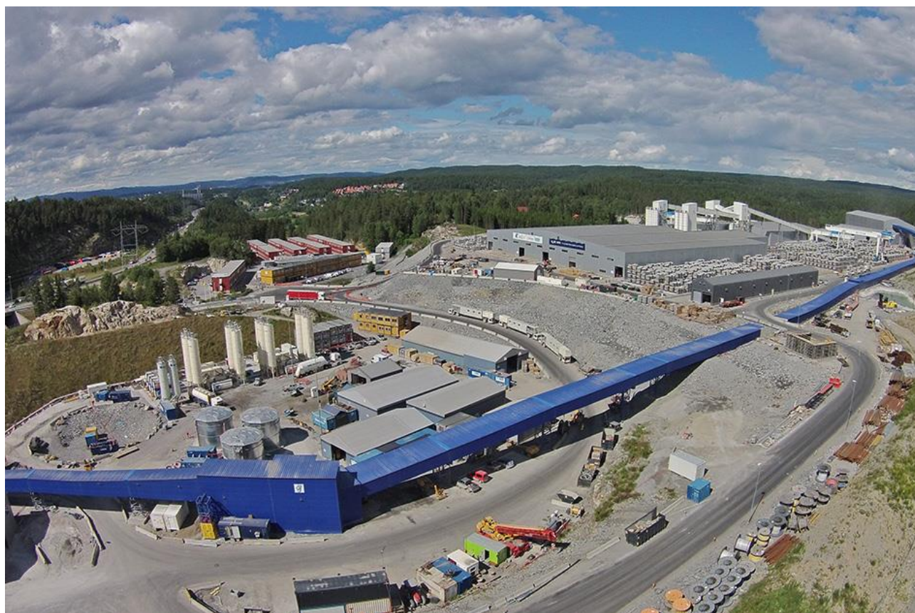
Figur 2. Bilde fra driftsperioden hentet fra Bane NORs hjemmesider. Bildet er tatt mot nord med E6 i synlig i bakgrunnen. «Low area» synes i nedre venstre hjørne. Betongelementfabrikken synes til høyre.
