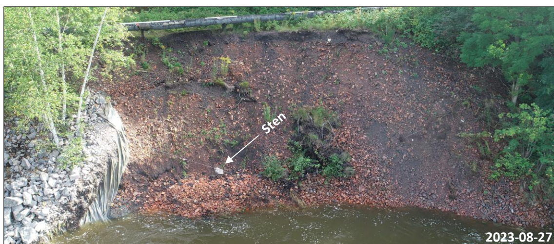
Figur 3.14: Dronefoto vinkelrett på erosjonssår nr. 2 ved ca. 2200 m 3 /s vannføring i Glomma, som viser tydelig overflatesig.
