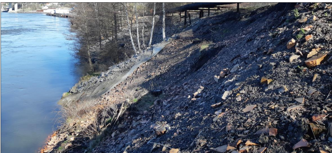
Figur 7 «Erosjonssår nr. 2» hvor det tidligere har gått to ras, avbildet under befarig 2023-04-21.
