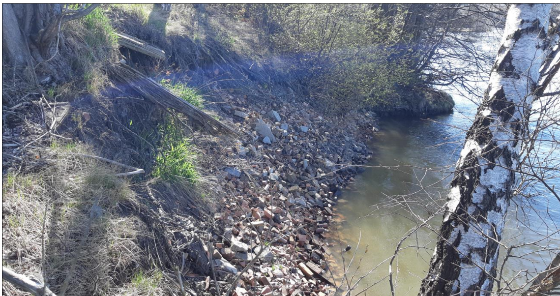
Figur 6 – «Erosjonssår nr. 1» avbildet under befarig 2023-04-21.
