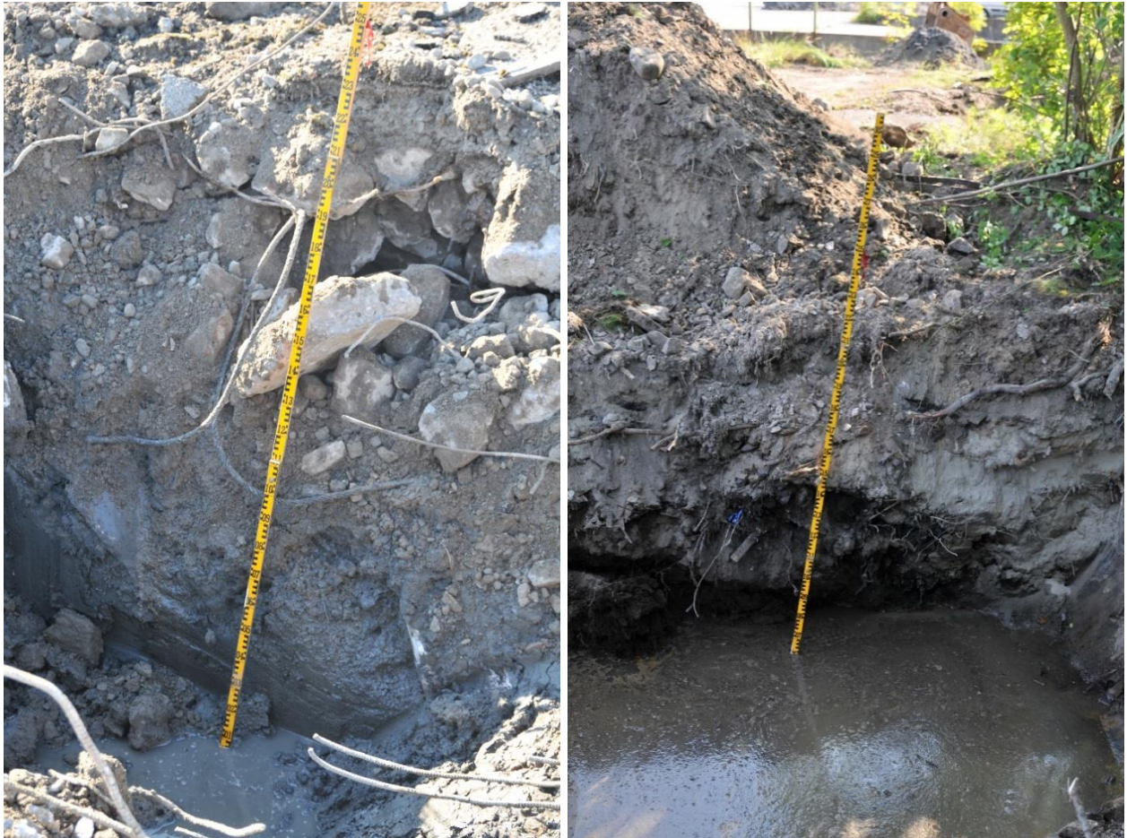
Figur 9. Bilde til venstre viser sjakt SAG08 og illustrerer mengden av betong og armeringsjern som foreligger ute på den svære flaten før nedkjøringsrampen til eksisterende bygg mot vest. Tilsvarende masser gjenfinnes i sjakt SAG09 og 11. Bilde til høyre viser sjakt SAG14. Det foreligger et lag med avfall mellom 0,6-0,9 m (rustent metall skrap og plast), og fri fase olje på vannspeilet.
