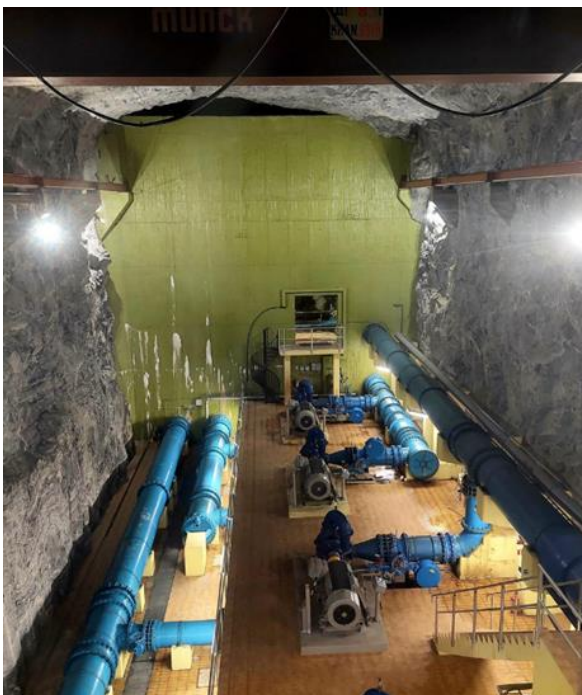
Figur 7 Bergrommet med pumpestasjon PV1
