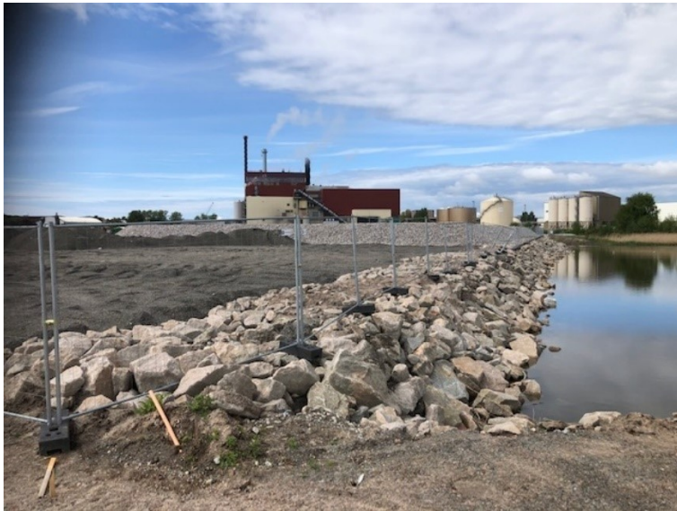
Figur 6-6, Bilde fra situasjonen ved området for nytt renseanlegg fra forsommeren 2022.
