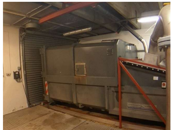
Figur 17: Eksisterende container for sand og ristgods.
