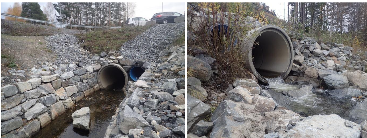
Figur 11 (a) Innløp kulvert Sellikbekken-Lågen
