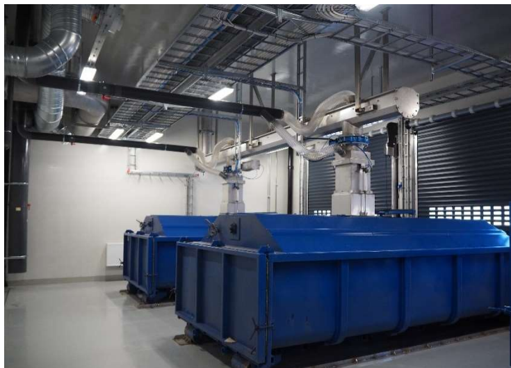
Figur 18: Lukkede Micodan-containere. God takhøyde og fordelingssystem.
