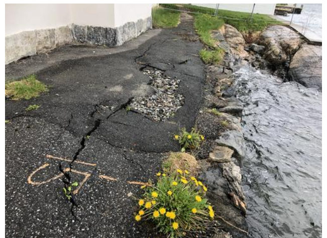
Utglidning av støttemuren foran Varmbadet
