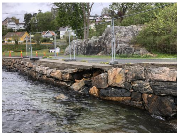
Utglidning av støttemuren ved handicaprampe
