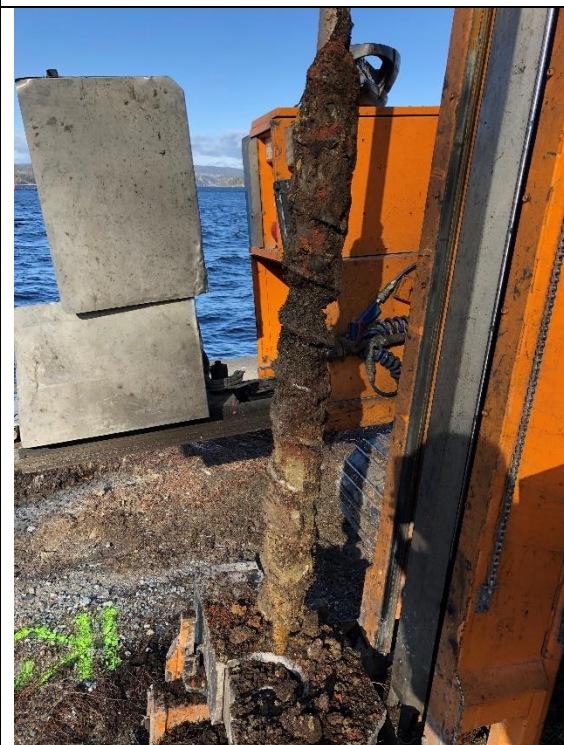
Bilde 11: Masser i punkt M6 1-2 m. Fyllmasser ned til 1,3 m, deretter virker det til å være stedlige masser. Grov sand til å begynne med, fin sand fra ca. 1,5 m. Vann på ca. 1,3 m (ved havnivå).
