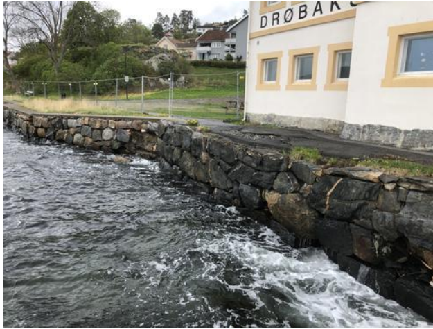
Utglidning av støttemuren foran Varmbadet
