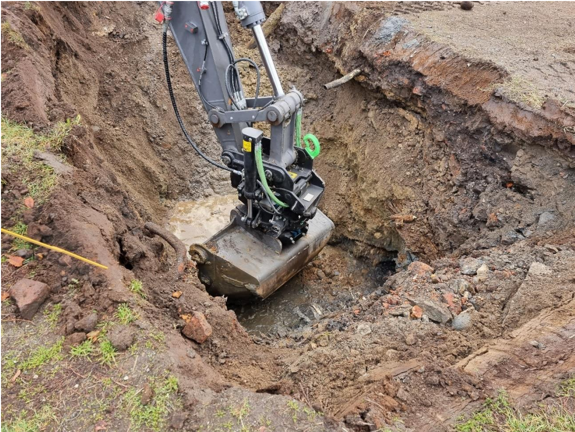
Figur 7: Prøvegrop 5, vanninntrengning ca. 2,5 m under terrengoverflaten.
