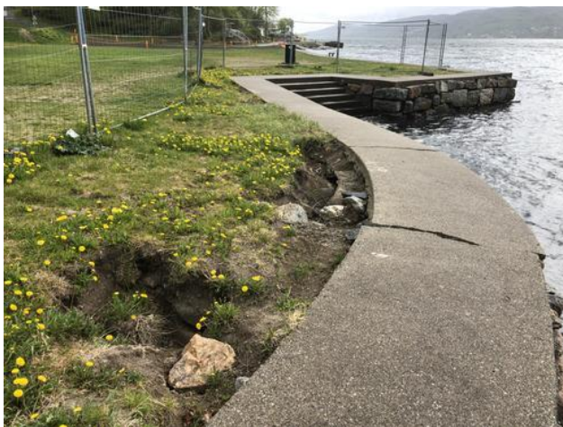
Synkehull og deformasjon av støttemuren på parrsletta
