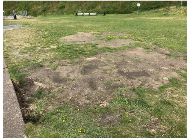
Synkehull bak støttemuren på Parrsletta
