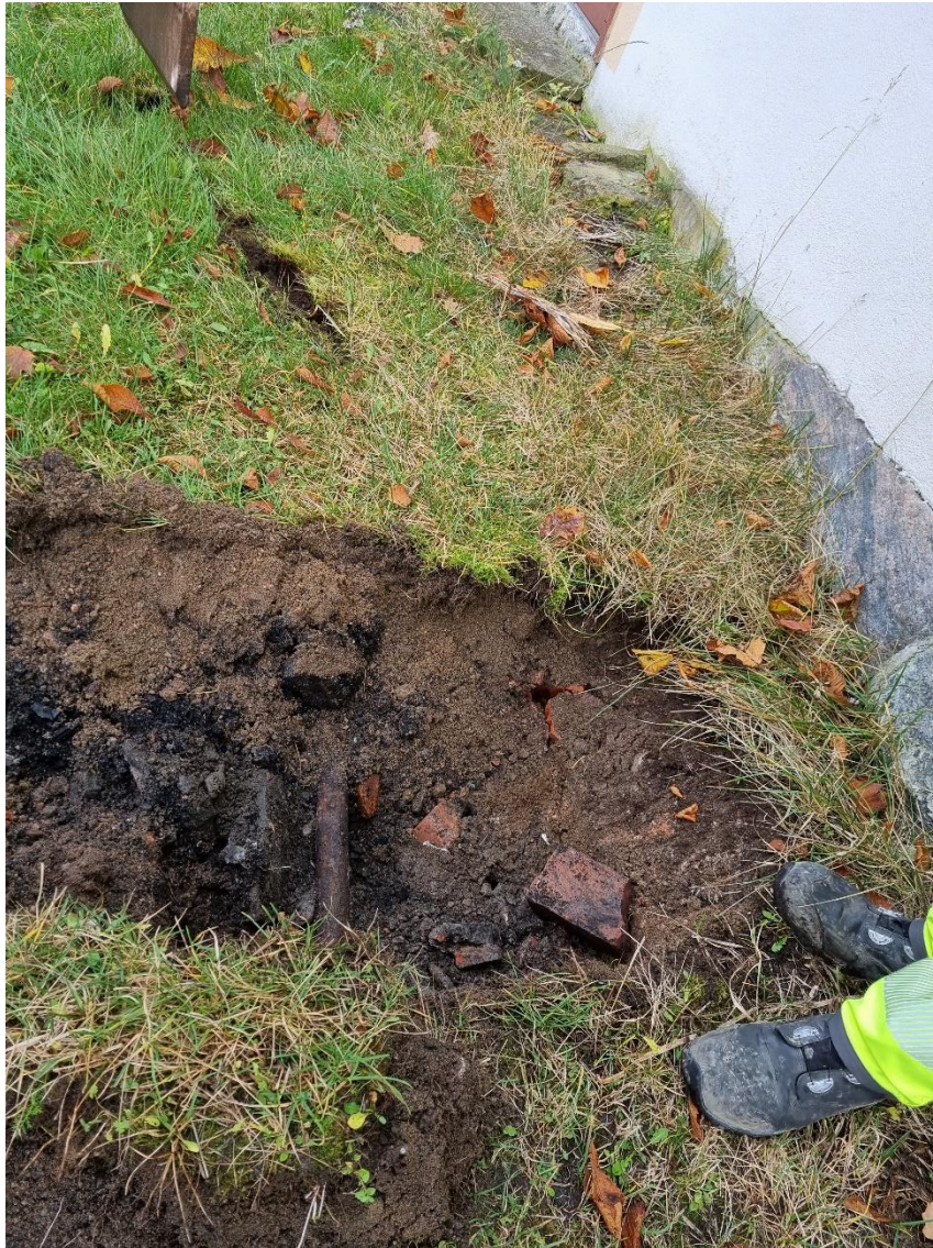
Figur 13: Prøvegraving ved Varmbadet, metallrør oppdaget nær fasaden mot nord
