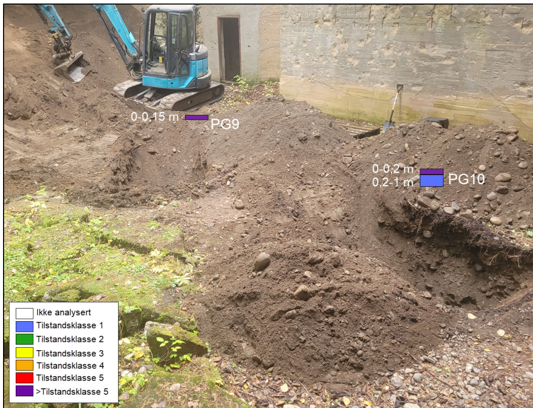
Figur 15. Forurensingssituasjonen til prøvegrøp 9 og 10 mellom skytevoll og betongtunnel.
